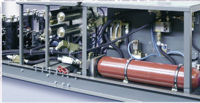
■ Filterstation und Emulsionsmischanlage
